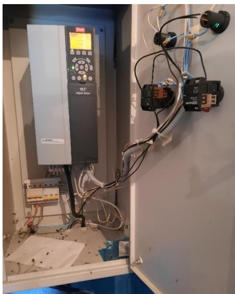
Оборудование (ПЧ) в НС-2п.
